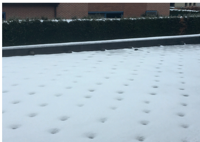
Foto 2 : smeltpunten in de sneeuw door warmtelekken op een plat dak, metalen (niet thermische) isolatiebevestiging. Photo 2 : la neige fond à cause des pertes thermiques, suite à l'utilisation des fixations non thermiques.
